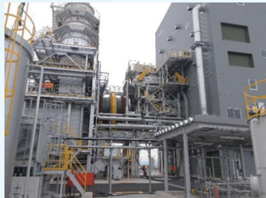
焼却発電施設
