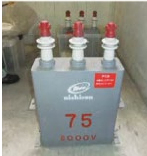
電力用コンデンサー
