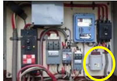
低圧分電盤内の低圧コンデンサー
