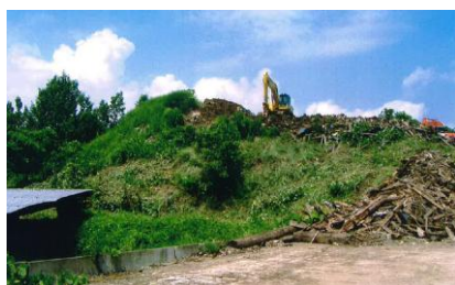
1)① 粗大物主体の現場（角材主体）
