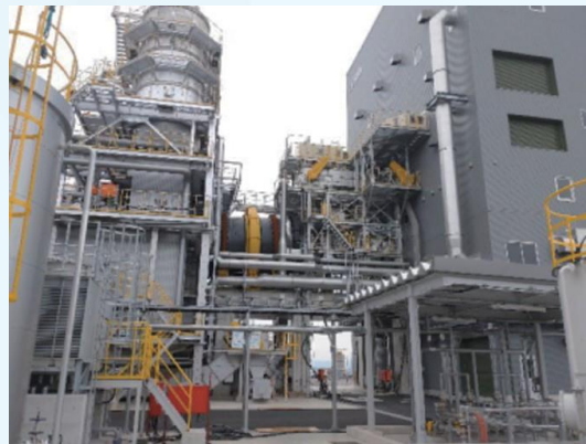
焼却発電施設
