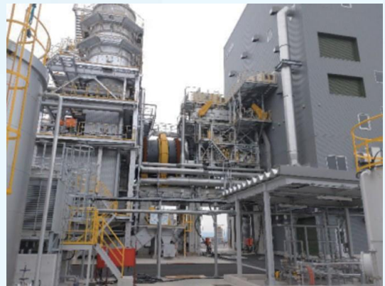
焼却発電施設
