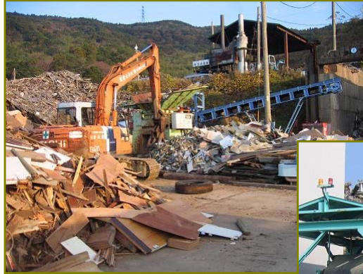
木くずの破碎・焼却 過剰保管堆積
