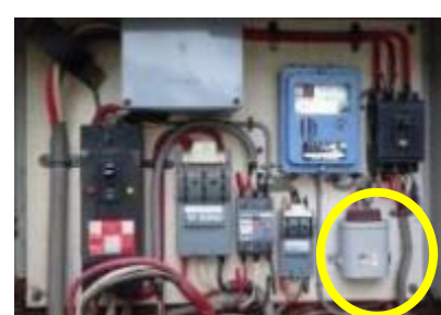
低圧分電盤内の低圧コンデンサー
