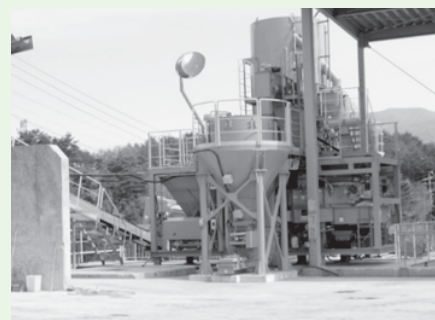
③無機汚泥処理施設
