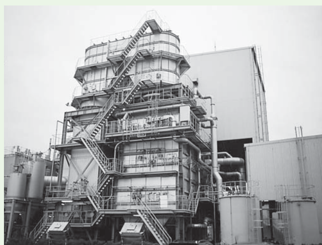
同社焼却炉の外観
