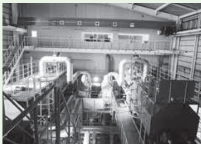
2系列の乾燥工程
