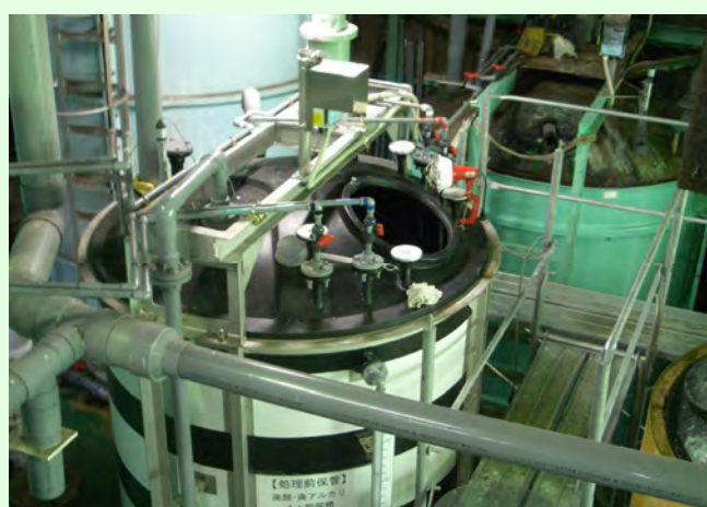
化学処理施設(八王子工場)
