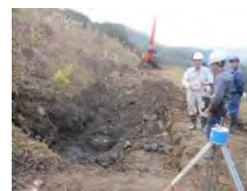
4)土砂・がれき主体現場
