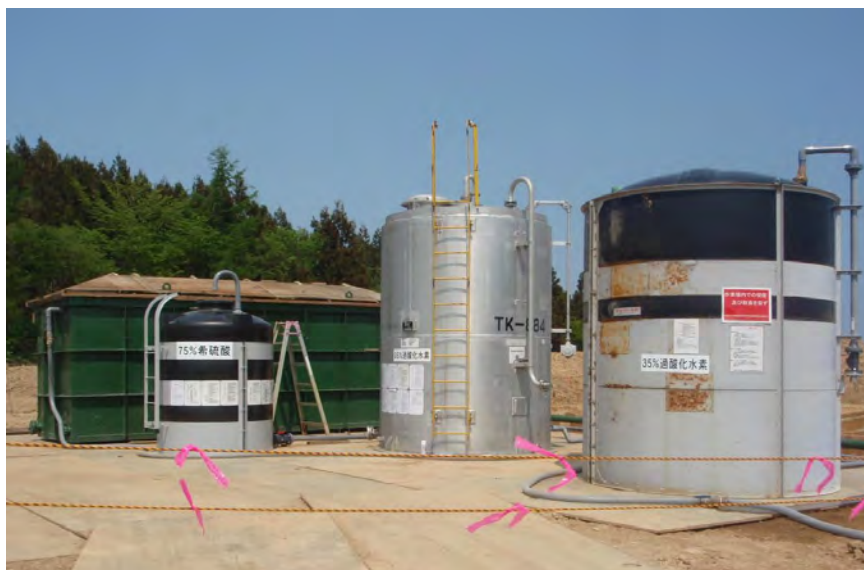
写真4 フェントン薬液タンク
