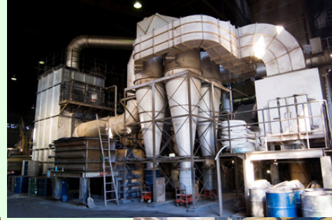
館林工場で 破碎焼却
