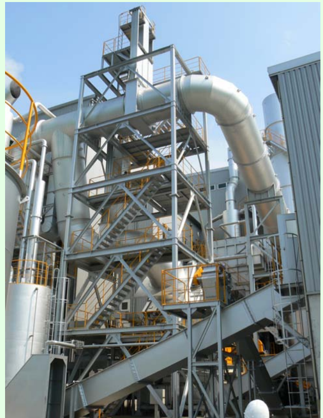
多段炉の外観と燃焼ガスのダクト
