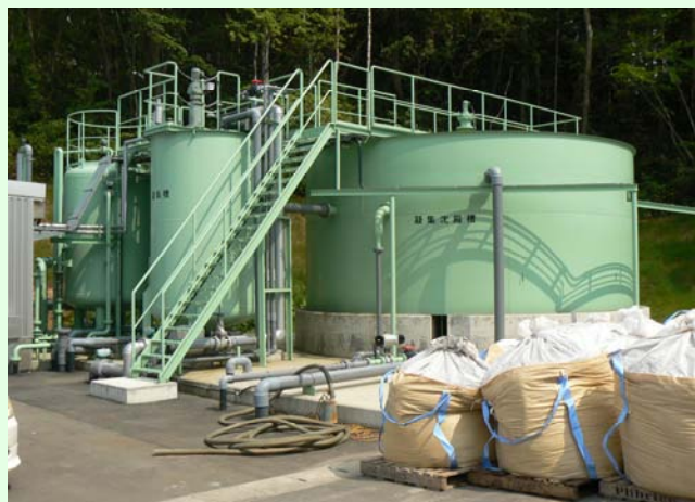
高度水処理装置(クローズドシステム)
