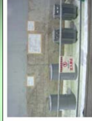
トランス・OFケープル保管
