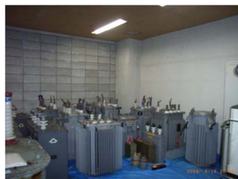
機器保管状況(改善前)
