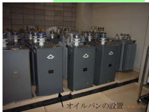
機器保管状況(改善後)
