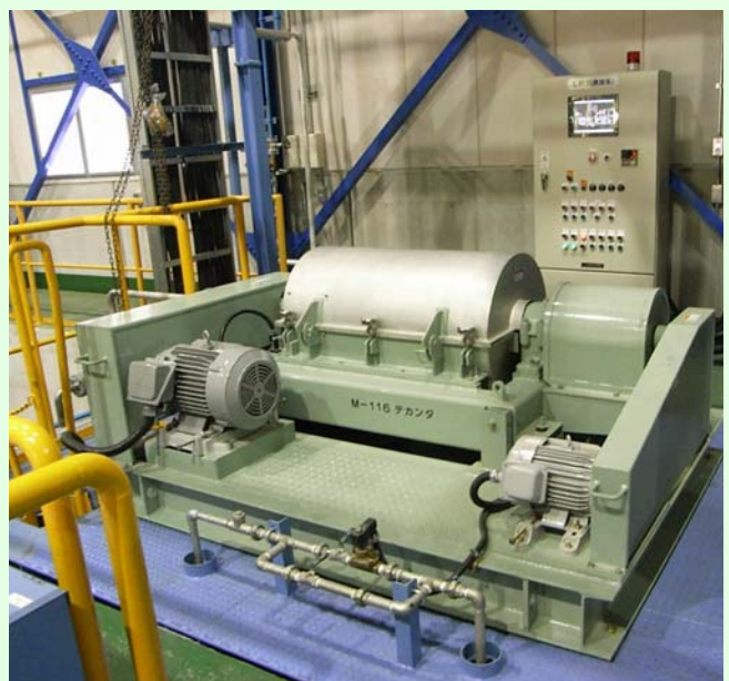
本機前段階での脱水機
