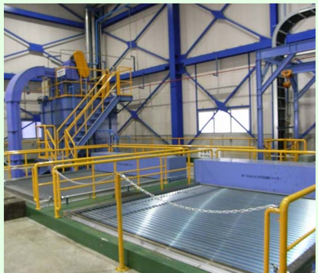
動植物性廃棄物破碎機(左)とシャッター付汚泥ピット
