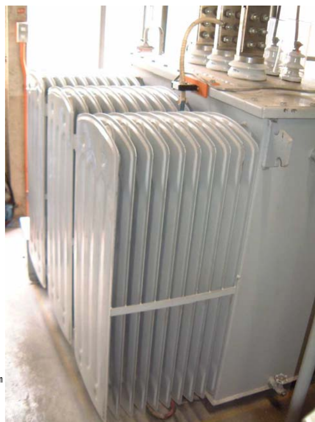
低濃度 PCB トランス
