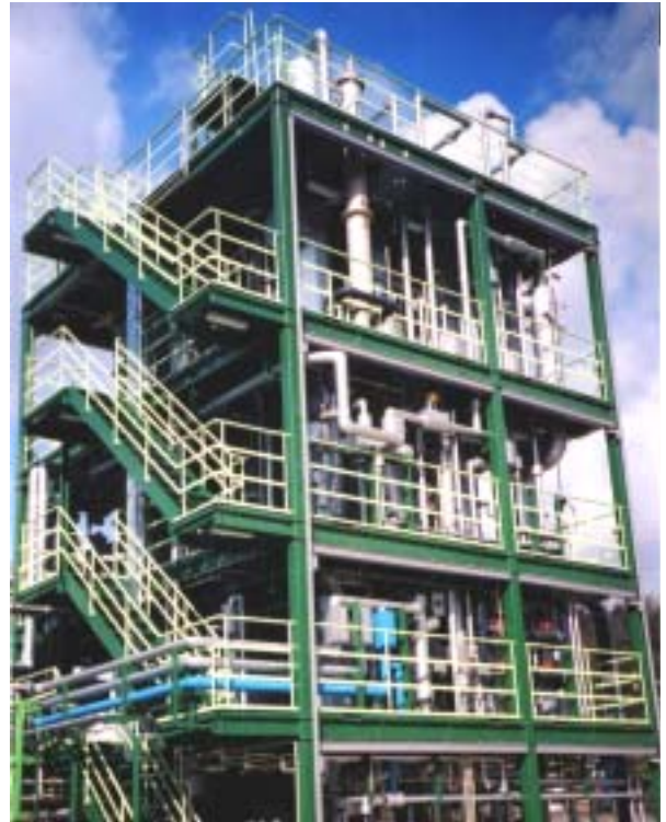
浸出水処理施設の蒸発法設備
