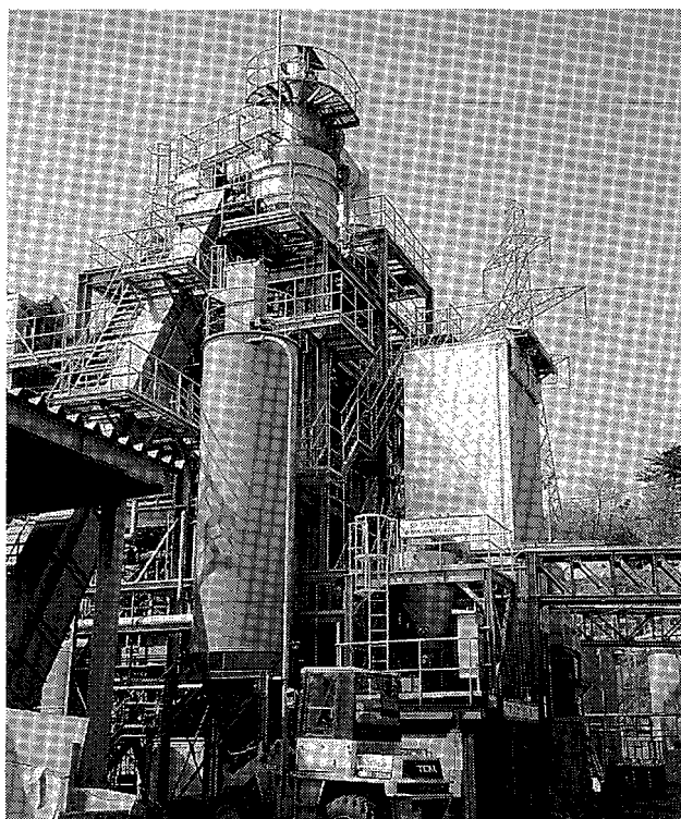
汚泥、廃プラ、廃油等の焼却を行う循環式流動焼却炉・下水汚泥など焼却処理している
