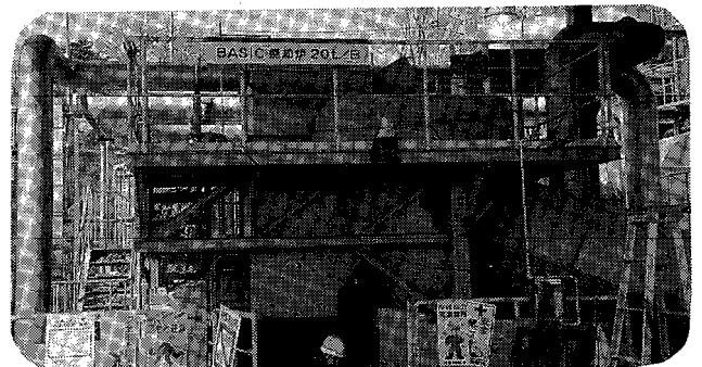
吊り下げ式のストーカ構造を持つBASIC焼却炉 主に木屑、廃プラ等を2次、3次燃焼室で完全分解
