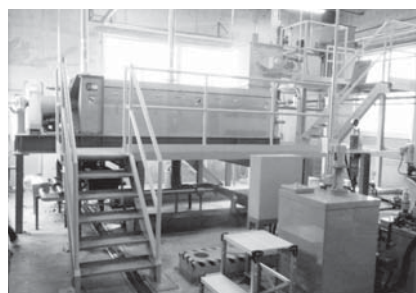
産業廃棄物抑制及び再利用施設整備への支援(脱水施設)
