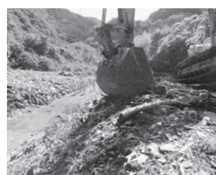
写真4 法肩(勾配38°)への载荷 (崩れの発生なし)
