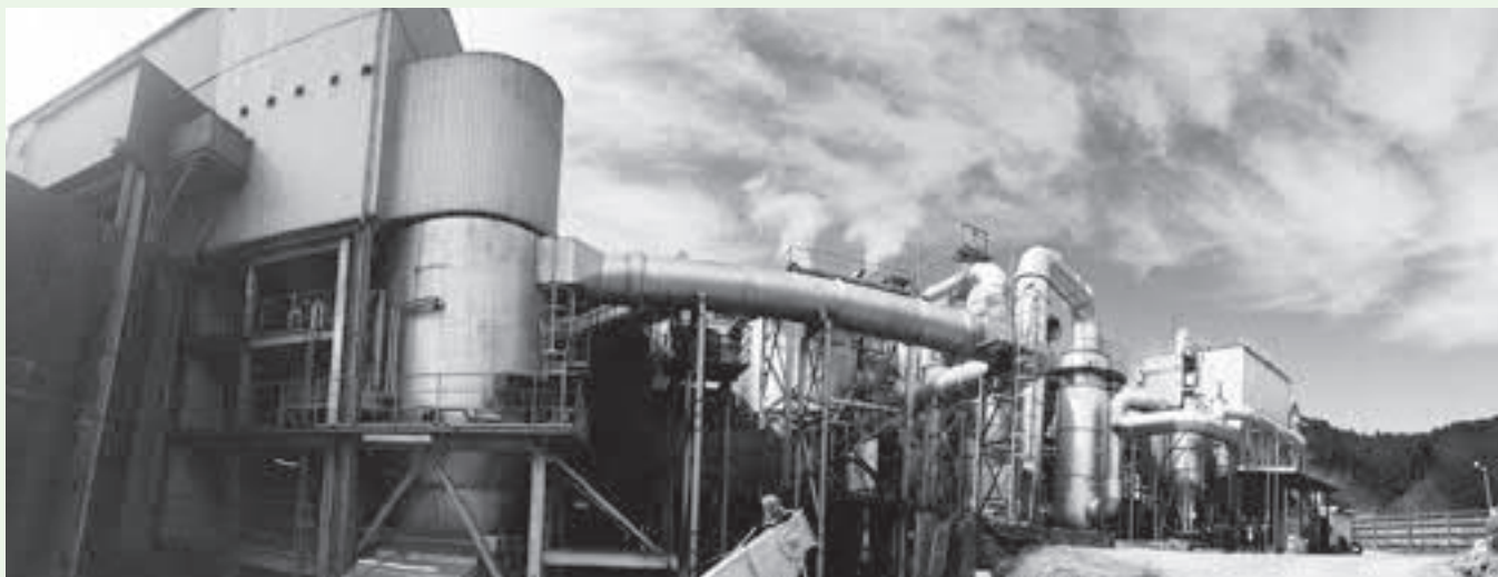
脊振りサイクル工場 焼却プラント
