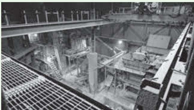
埼玉リサイクルセンター(RPF製造プラント)
